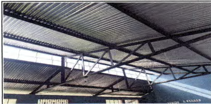
Foto 7: Lámina del módulo 1 con filtración de agua.
