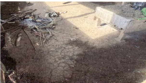
Foto 5: Cocina con piso rajado.
