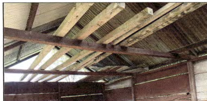
Foto 11: Estructura de madera erosionada.
