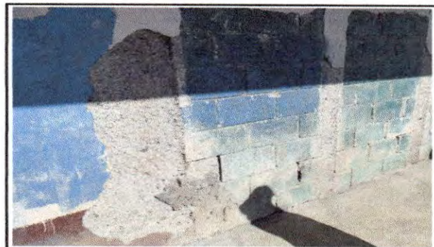
Foto 4: Muro de mampostería dañada.
