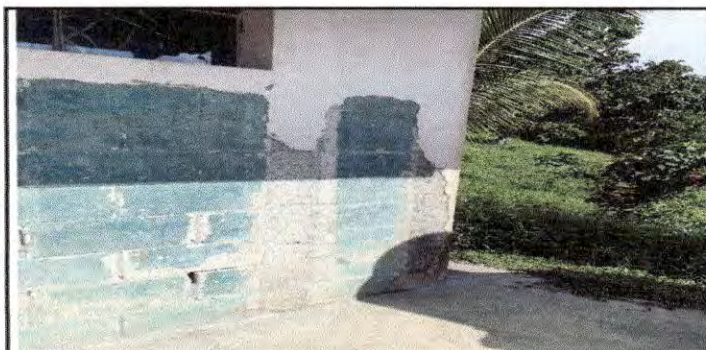
Foto 10: Muro del módulo 1 severamente dañada.
