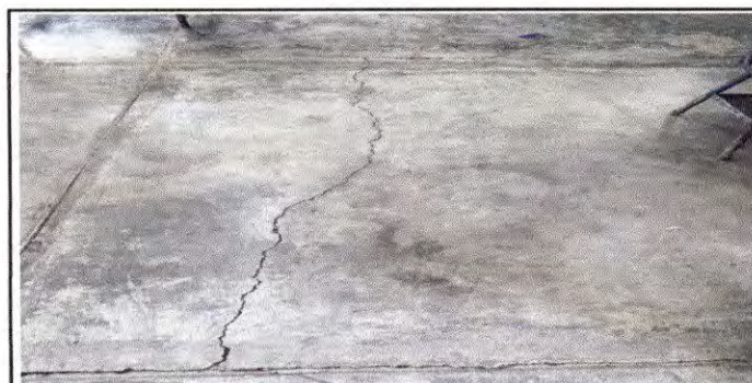
Foto 9: Piso del módulo 1 con quebrada.
