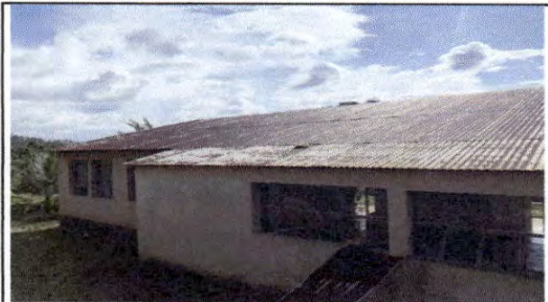
Foto 3: Lámina del módulo 1 dañada.
